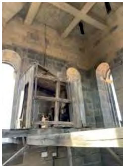
Montacargas (instalado durante el verano de 1949)
